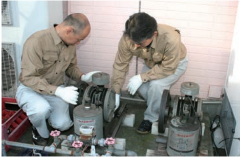
ブロワー(送風機)のチェック
